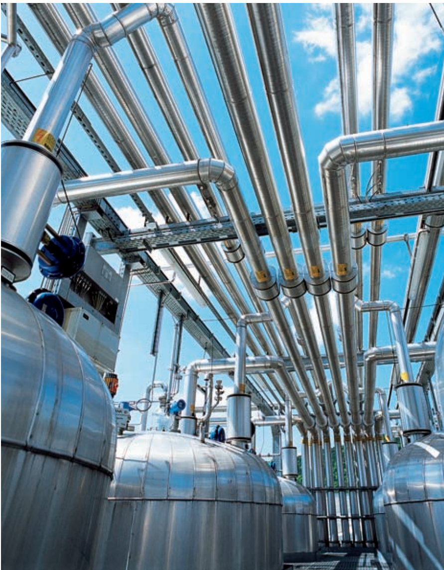
Dämmung mit Blechumhüllung
